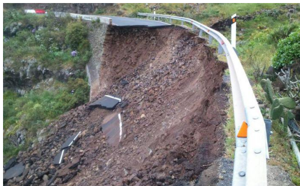
Figura 30. Derrumbe carretera GC-220. Isla de Gran Canaria, Fuente: Cadena SER
