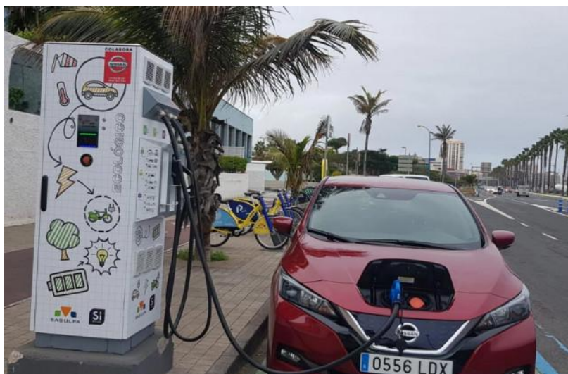
Figura 24. Ejemplo de estación de recarga de vehículos eléctricos. Fuente: Motor Tenerife.
