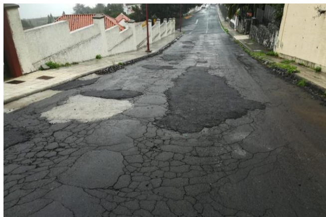
Figura 29. Grietas en Urbanización La Concepción, Santa Brígida, Isla de Gran Canaria. Fuente: noticiasdesantabrigida.com.
