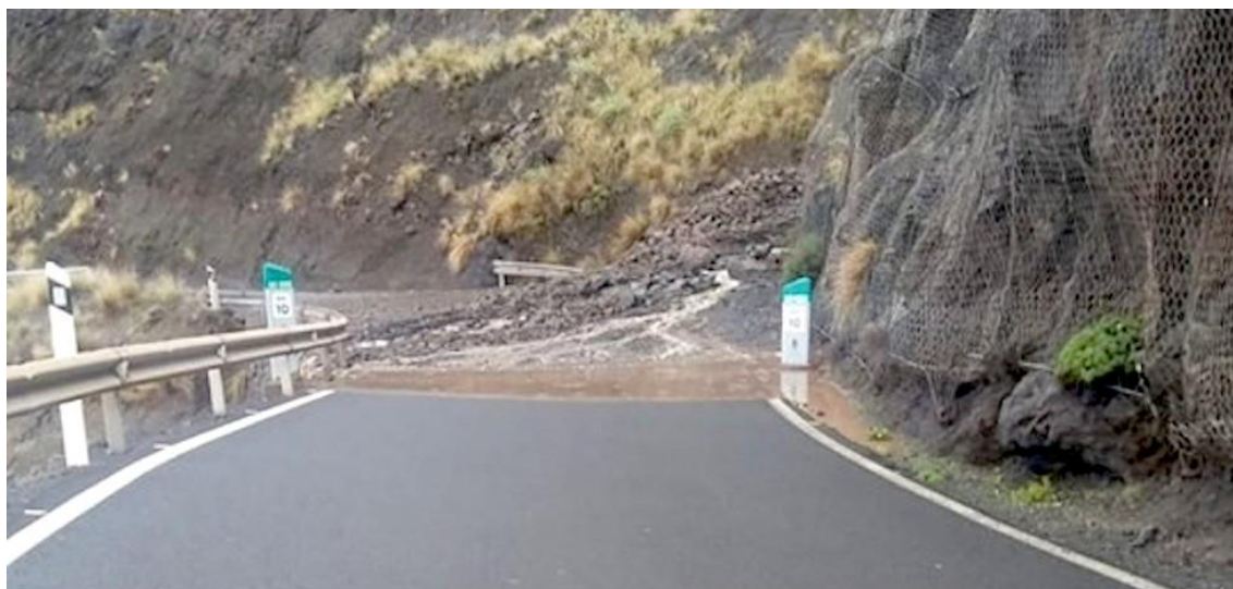
Figura 73. Carretera de La Aldea (Gran Canaria) cerrada por desprendimientos. Fuente: Maspalomas Ahora.
